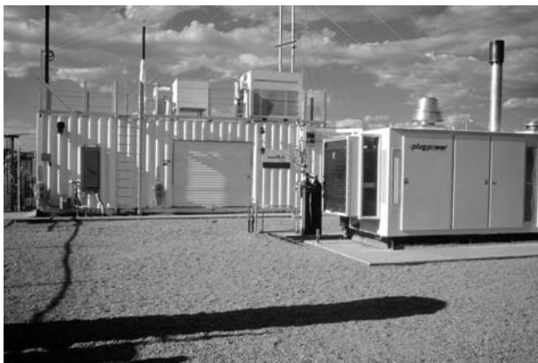
Links der Erdgasreformer (Air Products), rechts die Brennstoffzelle (Plug Power)
