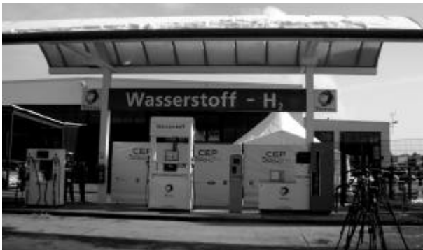
Die neue Wasserstoff-Tankstelle auf dem Bus-Betriebshof in Berlin-Spandau Fotos: DWV
