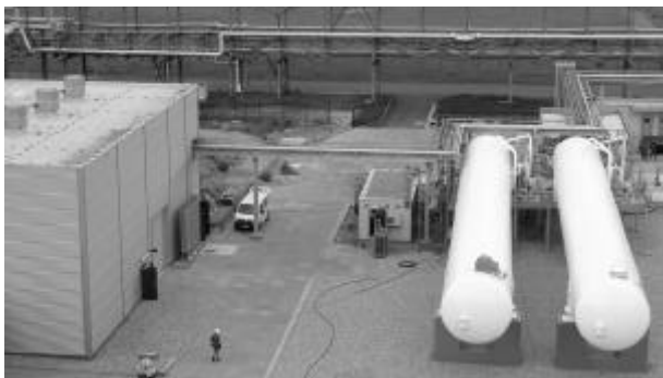
Links: Verflüssiger-Gebäude; rechts: Füllstation für Tanklastwagen
