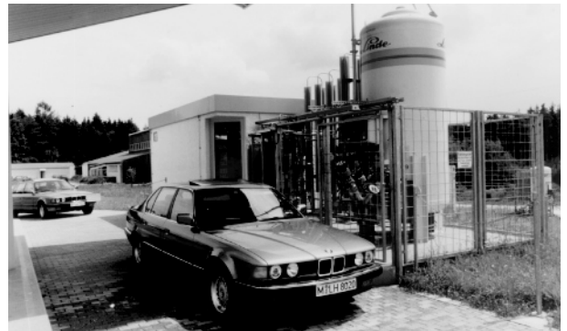
Tankanlage für PKW-Prototypen mit Flüssigwasserstoff bei der SWB Foto: SWB
