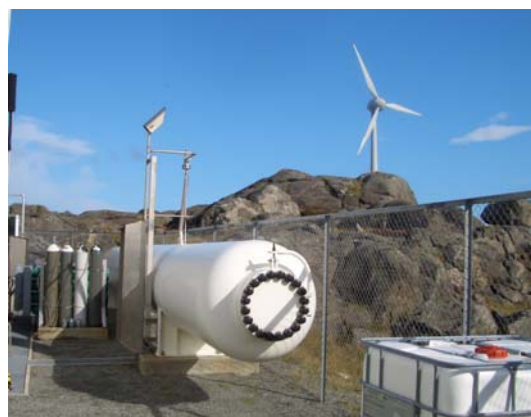
Windturbine und Wasserstofftank zur Speicherung der Windkraft auf der norwegischen Insel Utsira
